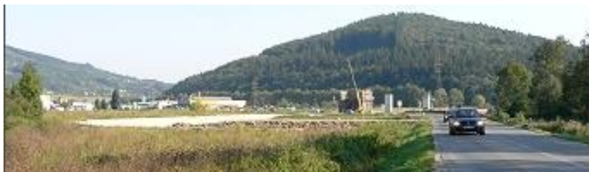
Obr. 5: Pohled na staveniště v oblasti budoucího MÚK - Semetín. V prvních měsících stavby.[27]
