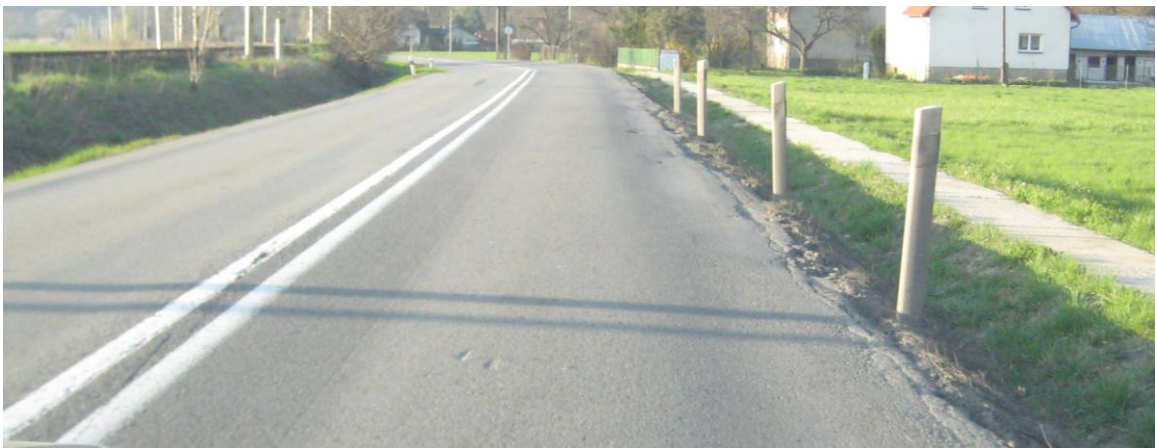
Obr. 11: Silnice I/57 v úseku zvaném pod Křížem, kde se krajnice bortí. [30]
