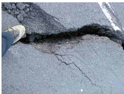
Obr. 26. Tahová trhlina v cestě [23]
