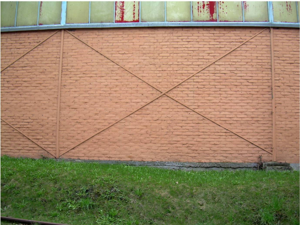
V ZÁPADNÍ ČÁSTI AREÁLU NATŘELI NA "CIHLOVO" téměř každou cihlu. Tady to vzali i s ocelovou konstrukcí
