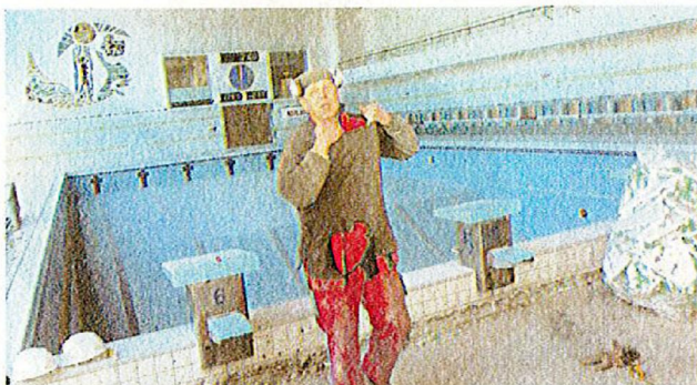
REKONSTRUKCE. Stavební úpravy na Čapkárně jsou v plném proudu. Foto 7 / Martin Straka
