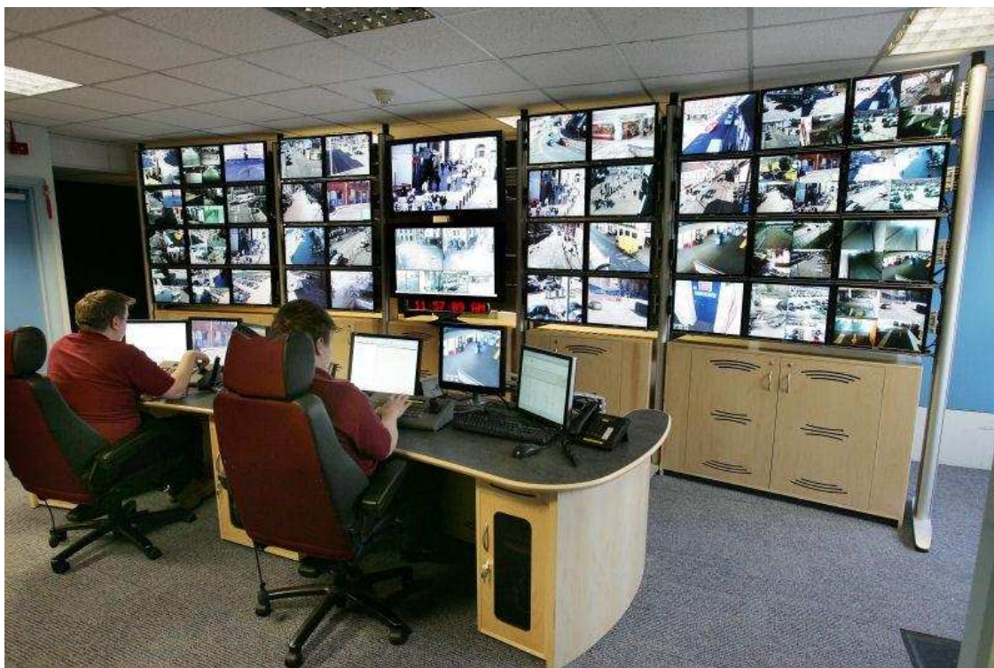
Obr. 1 – dohledové centrum CCTV systému, zdroj: http://www.chelmsford.gov.uk/
