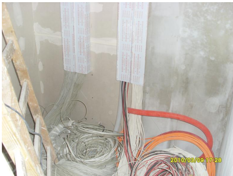
Obr. 16 Kabelová vedení v instalačních lištách [27]
