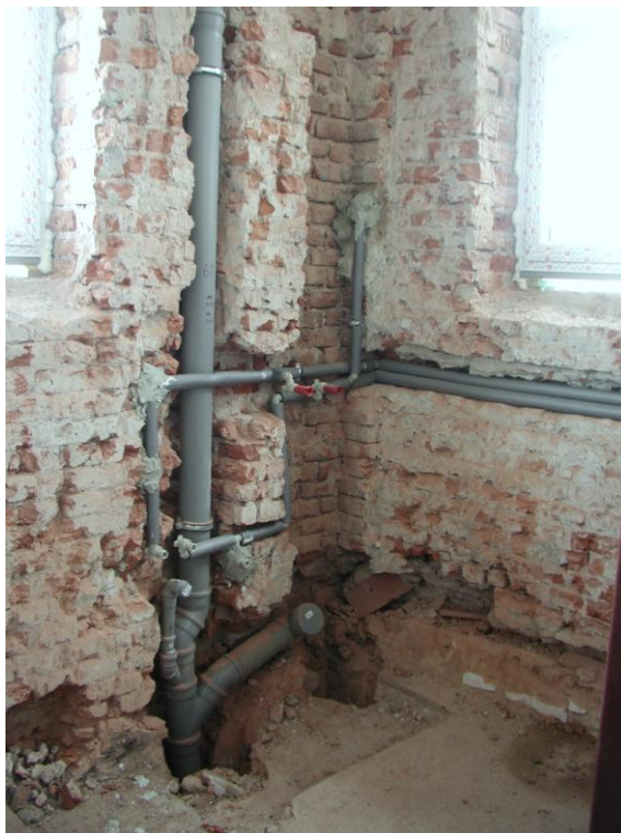
Obr. 11 Rozvody vnitřního vodovodu a kanalizace [26]
