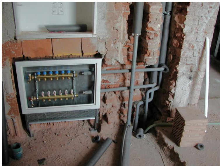
Obr. 10 Rozvody vnitřního vytápění, rozvaděč pro podlahové vytápění [26]
