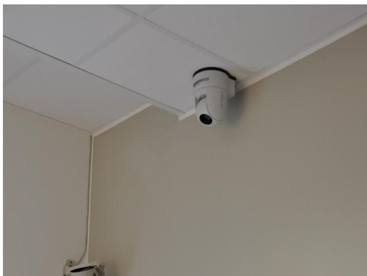
Obr. 20 Instalovaná PTZ kamera na SDK podhledu [26]
