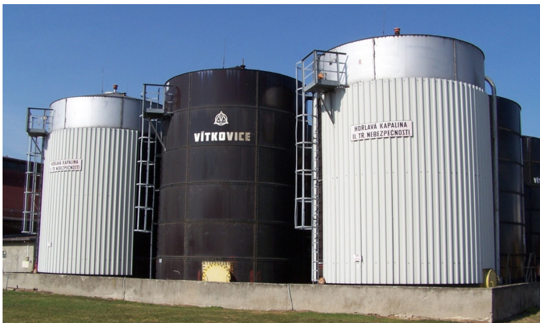
Obr. 11. Velkokapacitní nádrže na naftu N I a N II a na bionaftu
