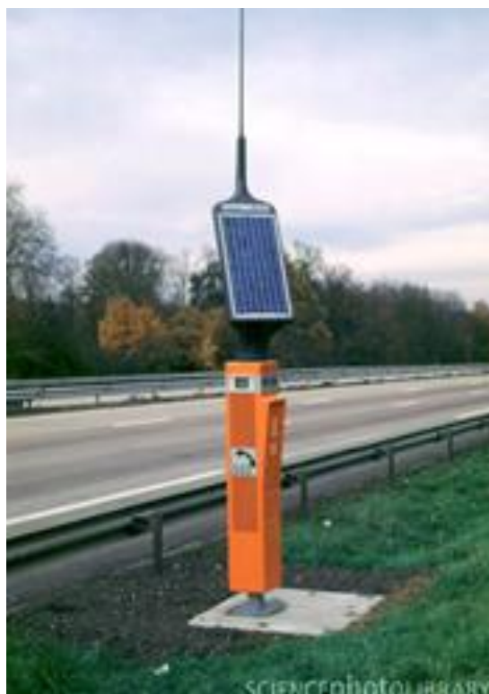
Obrázek 26. Stanice tísňového volání napájená FV panelem. [3]
