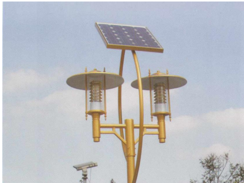
Obrázek 25. Sloup veřejného osvětlení napájen solárním panelem. [3]
