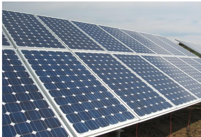
Obrázek 9: Fotovoltaické panely na skládce Suchý důl [26]
