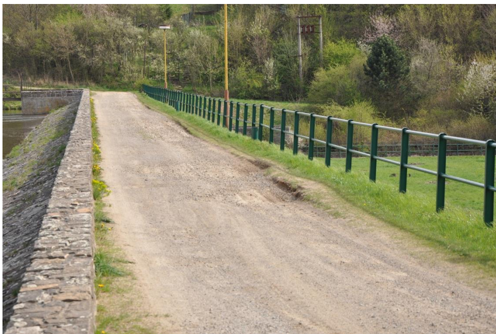
Obrázek 8: Aktuální stav komunikace na vodním díle.
