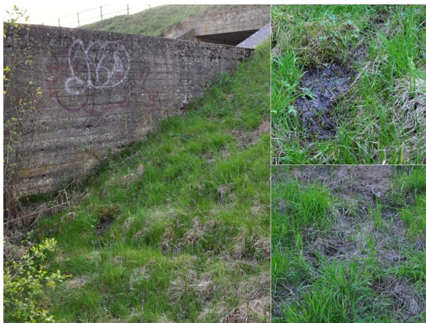
Obrázek 17: Vývěr vody na levém břehu hráze.
