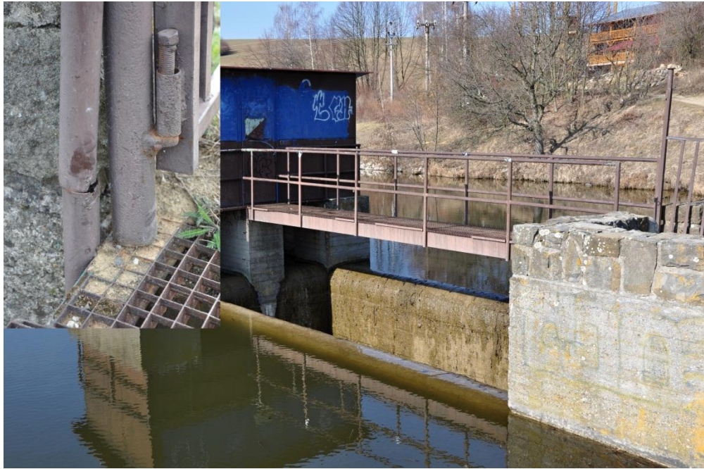
Obrázek 15: Stav železné lávky k armaturní věži.
