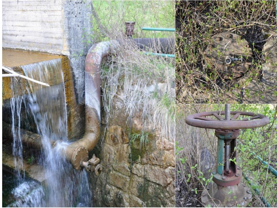
Obrázek 14: Odběrné potrubí pro závlahové účely.
