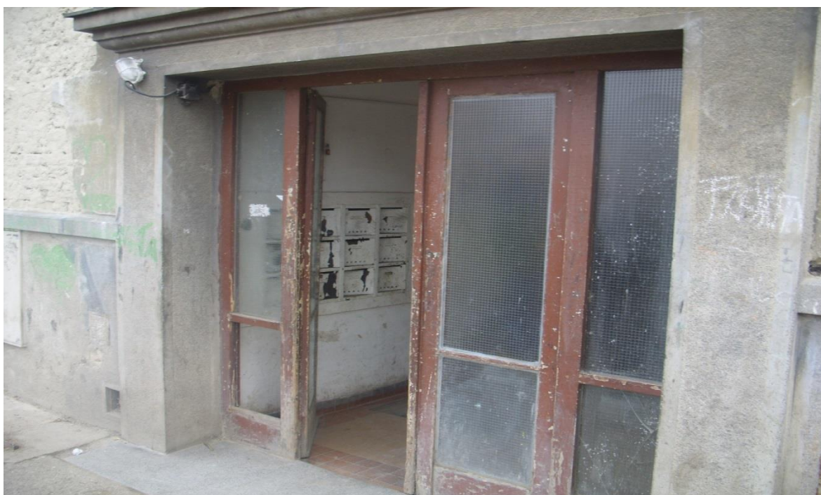
Obr. č. 4 - Ubytovna na ulici Markéty Kuncové 2 v Brně – Vstup do ubytovny s nefunkčními poštovními schránkami
