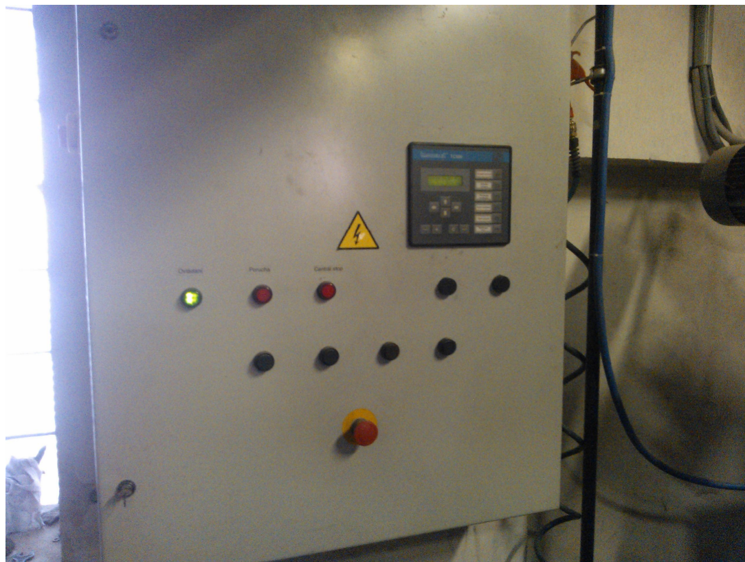
Obrázek 10: Počítač hlídající přetlak a podtlak v kotelně
