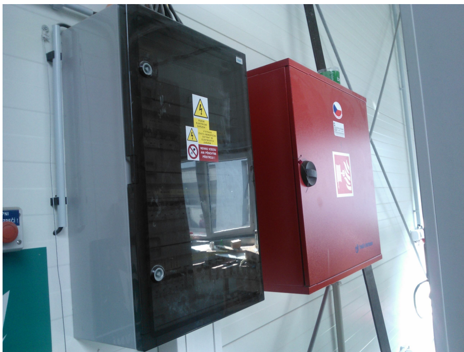
Obrázek 15: Hydrant zavěšený na zdi v jedné z dvou nových hal
