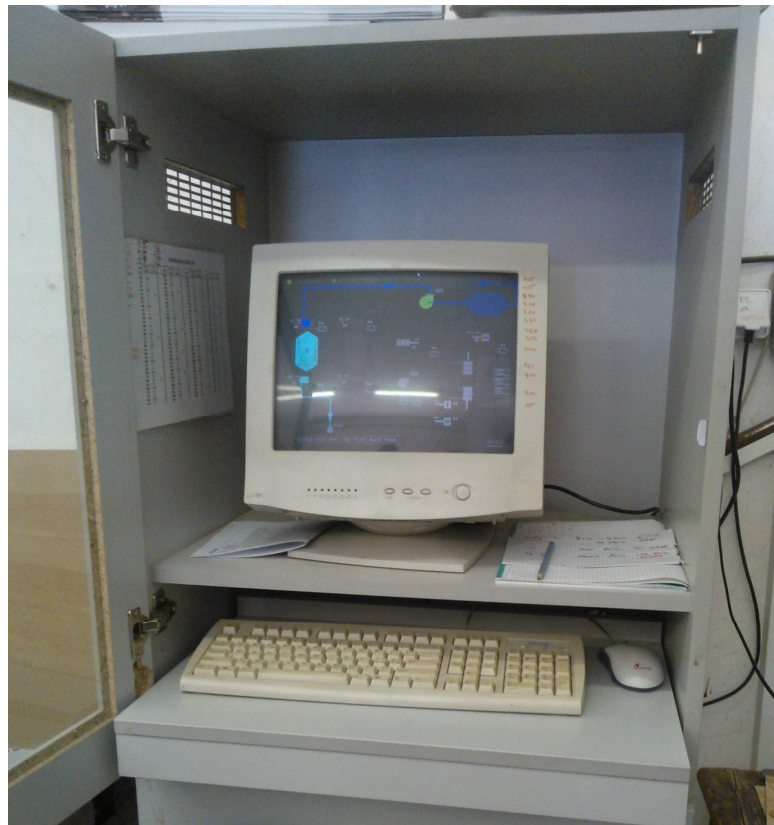
Obrázek 11: Řídicí systém čističky vzduchu v lakovně
