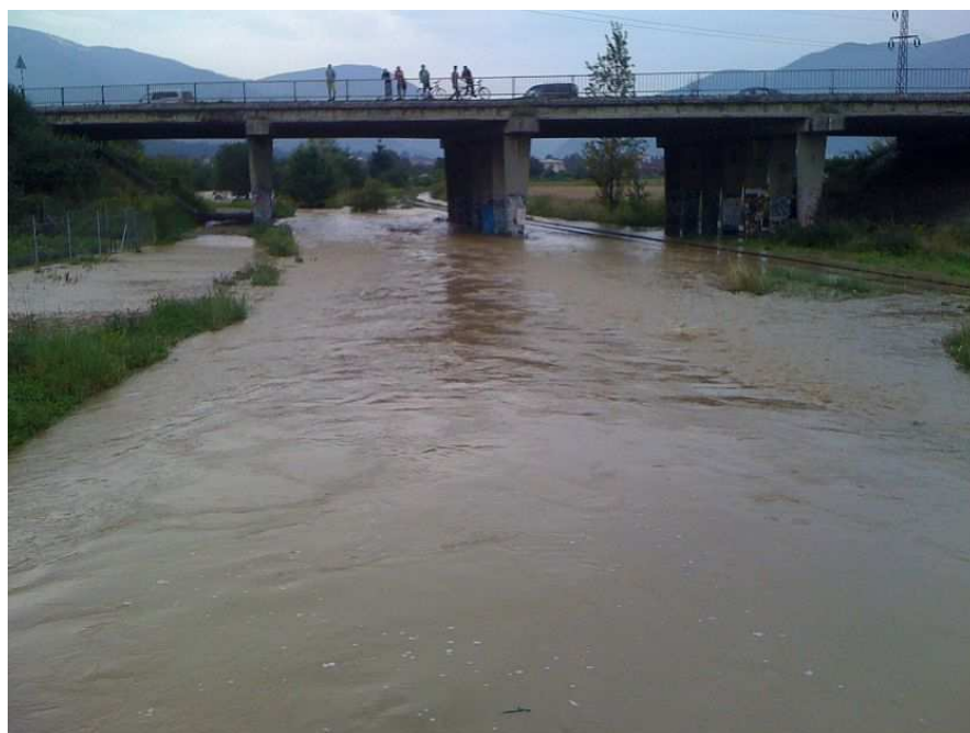
Zaplavená železničná trať
