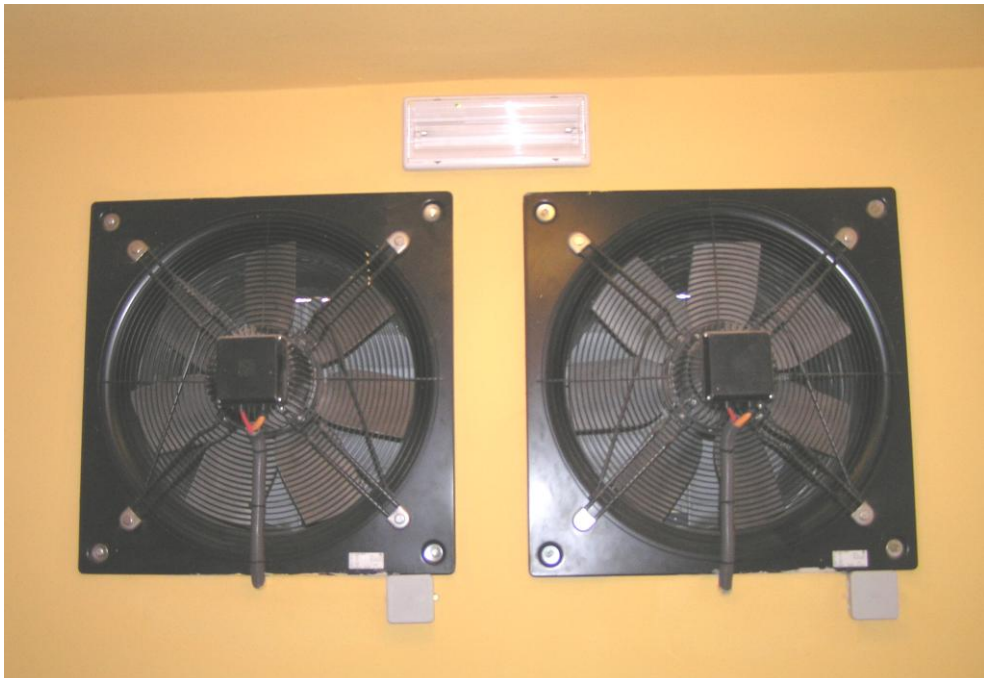
Obr. 6 Ventilátory přívodu vzduchu [12]
