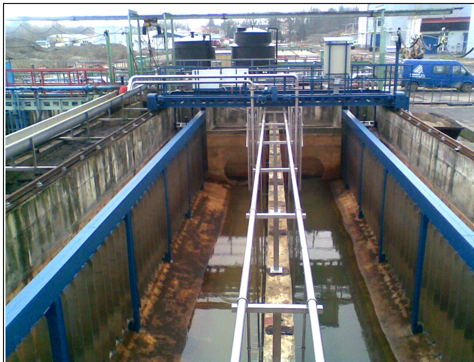
Obr. 11. Vystrojení lapáku písku a tuků č. 2
