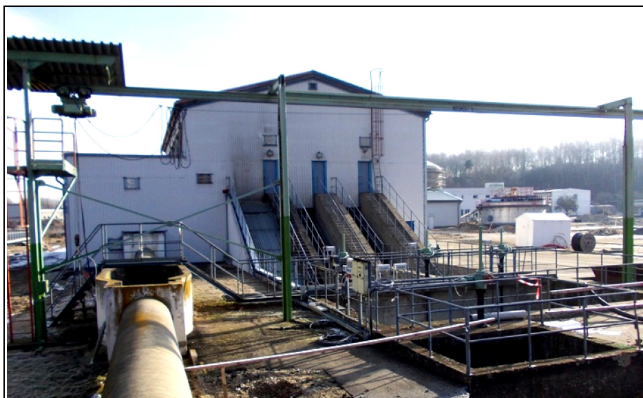
Obr. 1. Stoka B, lapák šterku a čerpací stanice OV na ČOV
