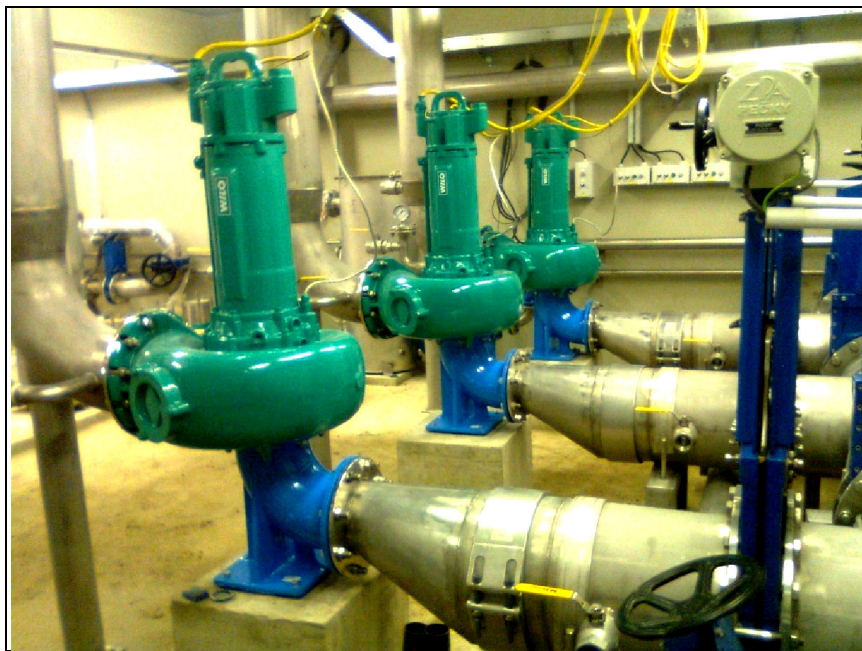
Obr. 13. Čerpadla vratného kalu
