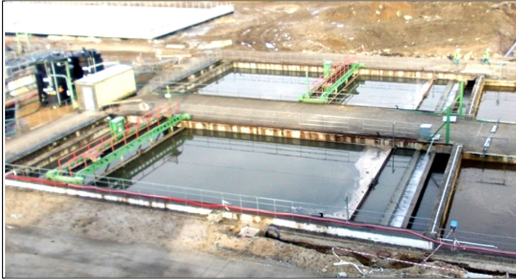
Obr. 4. Usazovací nádrže s pojezdovým mostem
