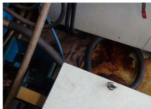
Pohozené utěrky na zemi, vytékající olej
