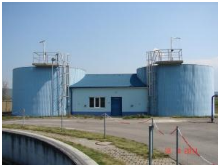
Obr. 18. Uskladňovacie nádrže na kal
