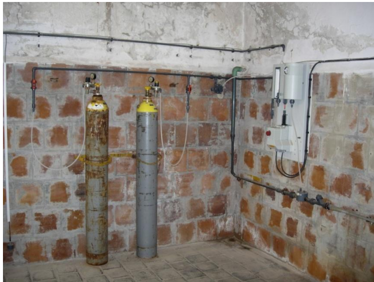
Obr. 7. Dávkovacie zariadenie na chlór a tlakové fľaše
