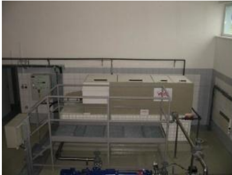
Obr. 17. Zahustenie a odvodnenie kalu
