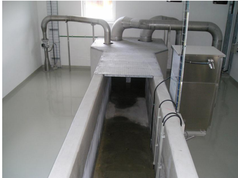
Obr. 11. Prítokové potrubia a žľab v predčistení
