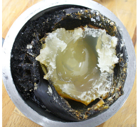
Obr. 44. Degradovaný PVC materiál.
