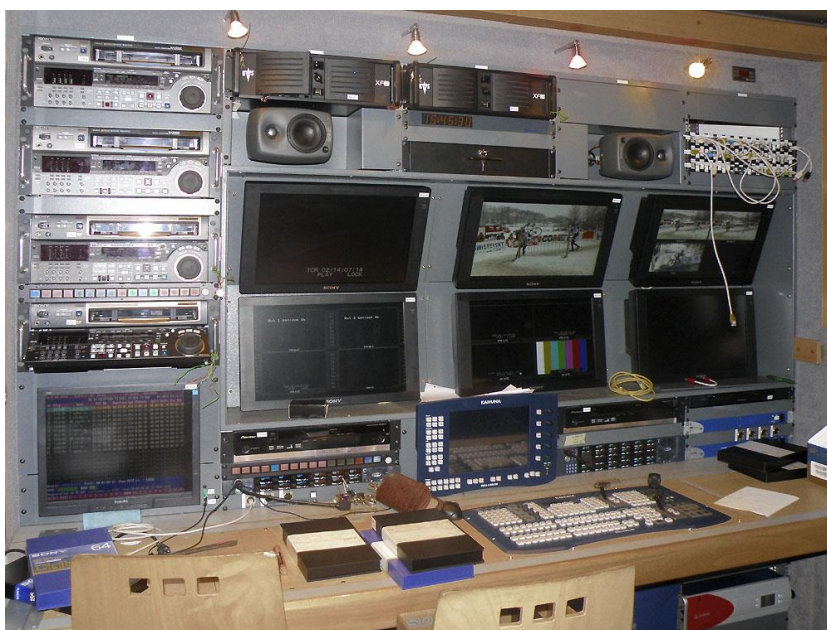
Obrázek 4: Interiér přenosového vozu 16
