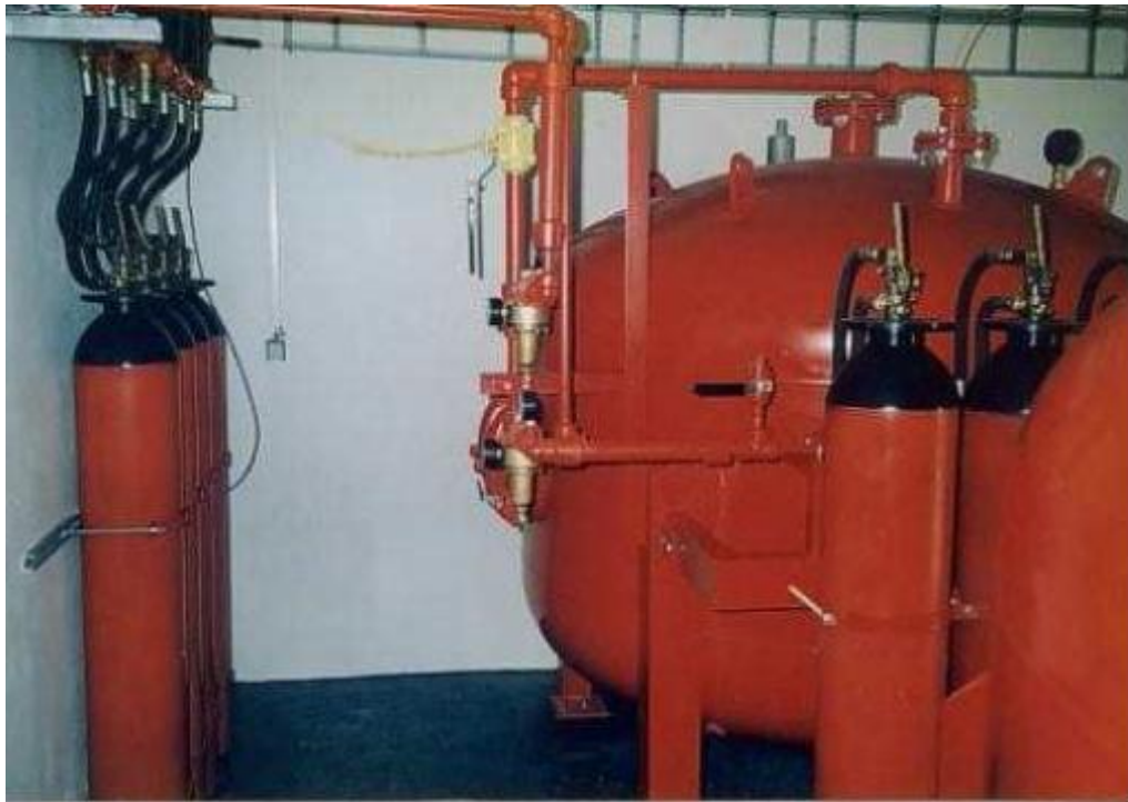
Obr. 11 Strojovna práškového SHZ
