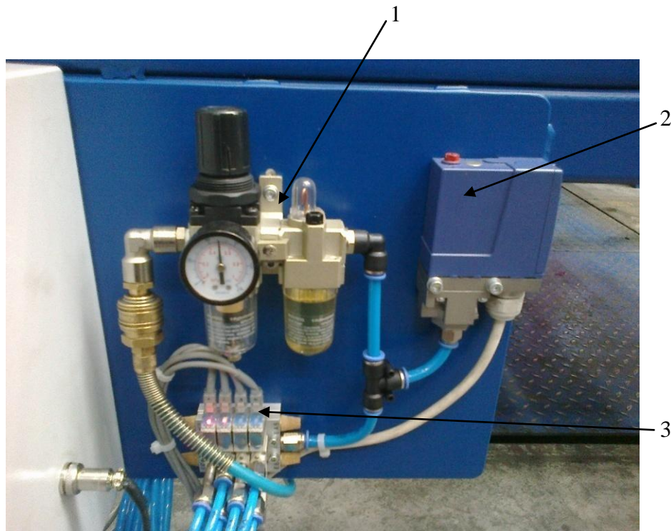
Obr. 43 Úpravna vzduchu a tlakový snímač
