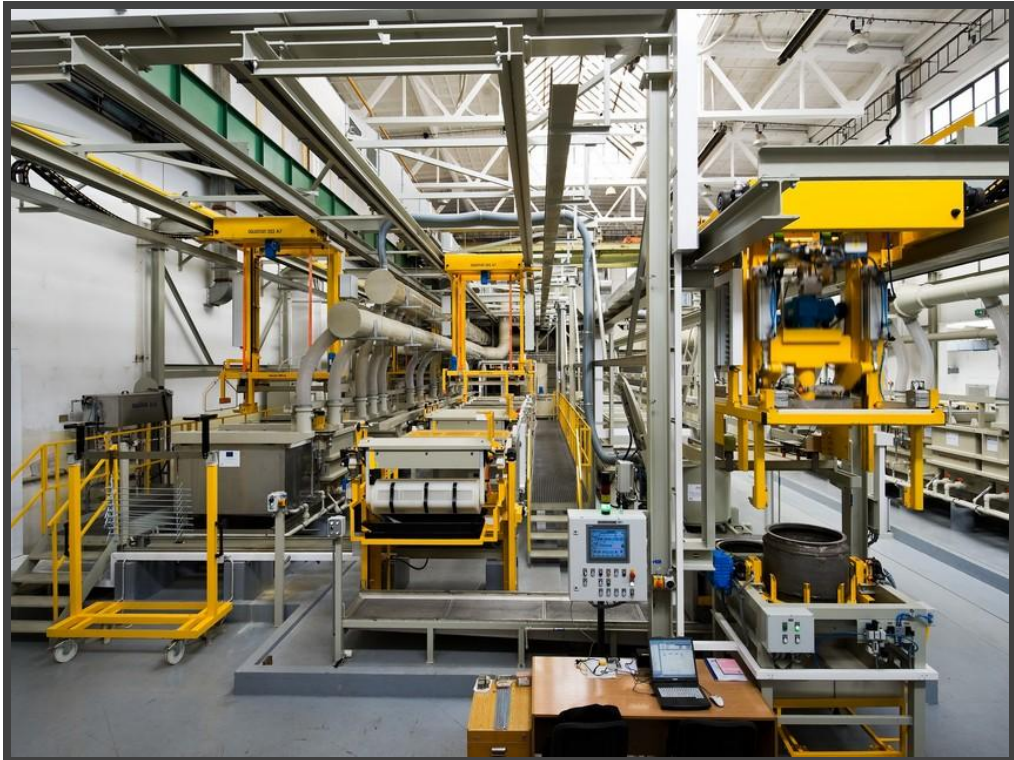
Obr. 25 Výrobní hala vybavena veškerou galvanotechnikou od firmy Aquacomp hard, sestavena do tří automatizovaných linek
