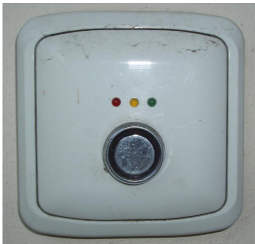
Obr. 9 Čtecí zařízení pro řízení přístupu do budovy
