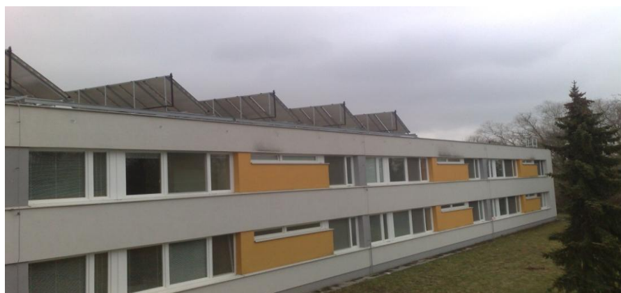
Obr. č. 35 Umístění fotovoltaických solárních panelů na rovné střeše
