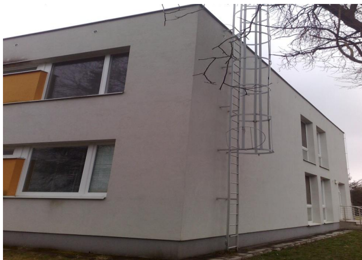
Obr. č. 24 Nezabezpečený přístup na rovnou střechu
