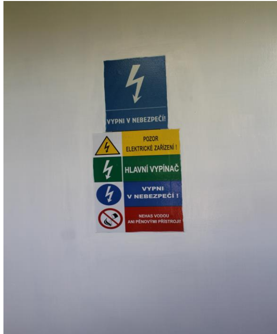
Obr. 13 Označení technického zařízení
