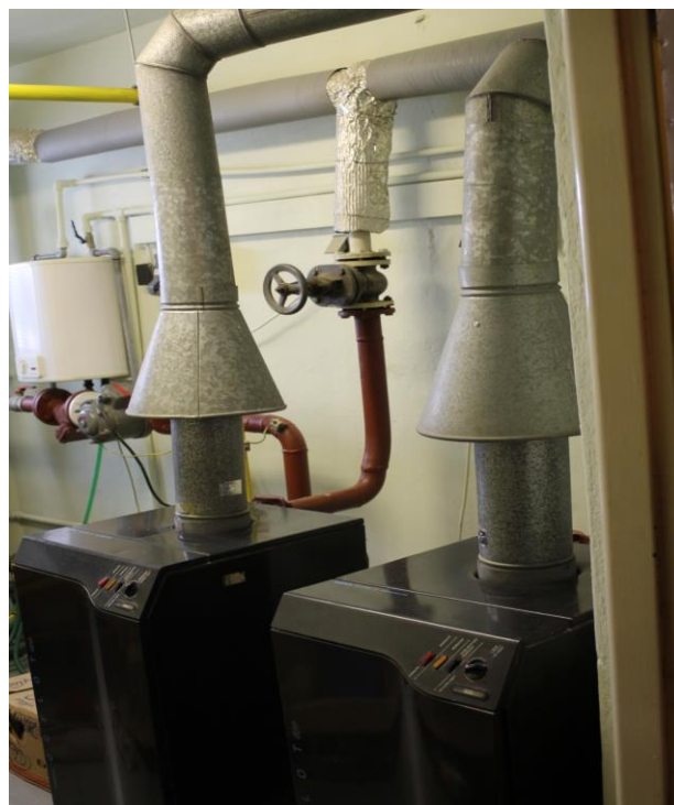
Obr. 10 Plynová kotelna [Zdroj: vlastní]
