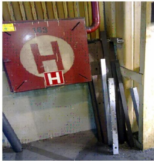
Obr. 27 Ťažšie prístupný hydrant
