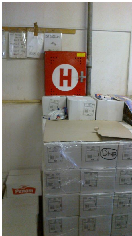
Obrázek 8 špatný přístup k hydrantu zdroj: vlastní
