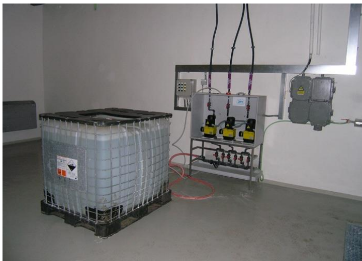
Obr. 4 Srážedlo fosforu PREFLOC připojené na dávkovací systém
