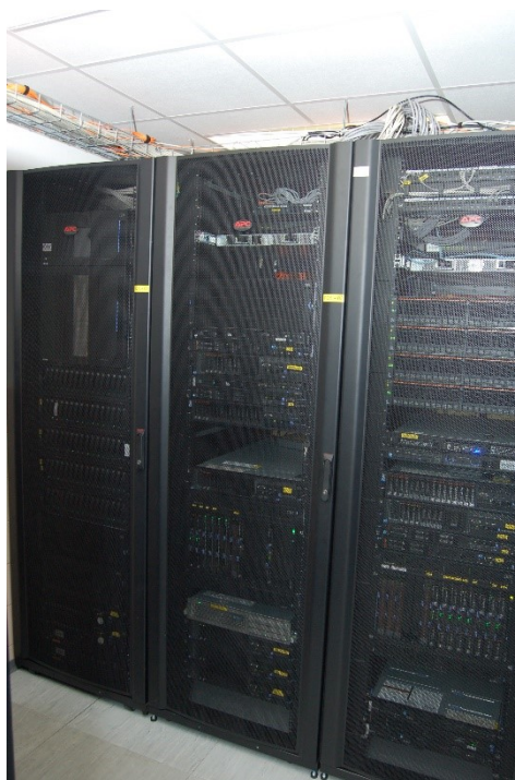
Obr. 5. Stávající datové centrum.
