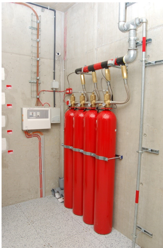
Obr. 29. Stabilní hasicí zařízení s ústřednou.
