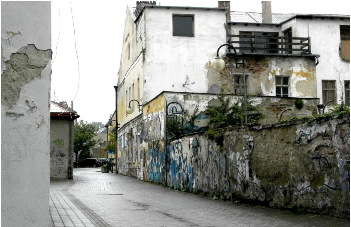
Obr. 15: Vandalismus a graffiti v ulici Malá
