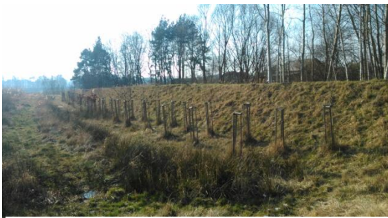
Obr. 4 - Protipovodňová hráz s biokoridorem [Zdroj: vlastní]
