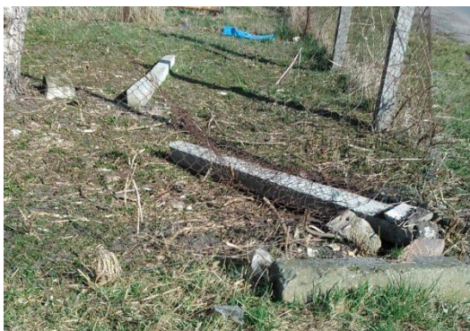
Obrázek 3. Stávající poškozený plot;
