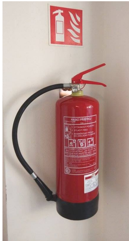
Obrázek 9 Hasicí přístroj v budově UH-1 [vlastní]
