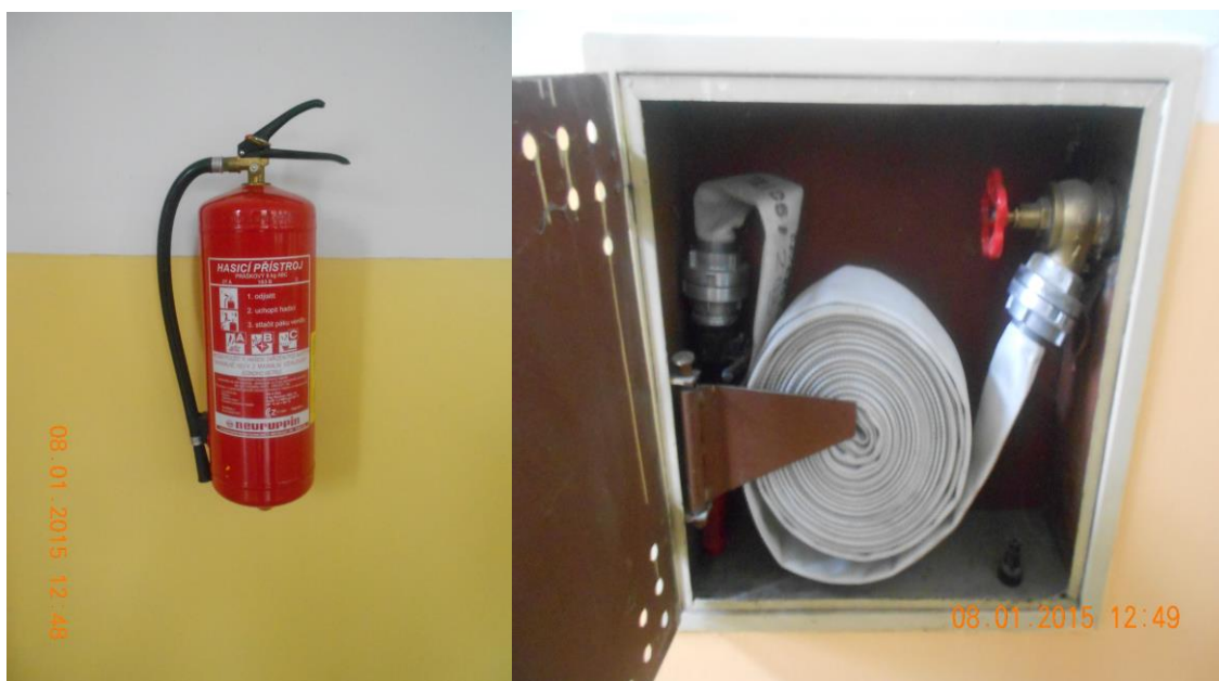
Obr. 5 Práškový hasicí přístroj a vodní hydrant [zdroj vlastní]
