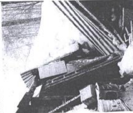
Pod tíhou sněhu se propadla střecha dřevě-né kůlny a zkratovalo elektrické vedení. Následný požár zničil věci za padesát tisíc korun. FOTO: HUS, ZK
