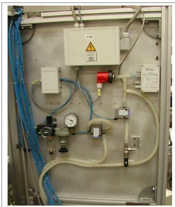
Obr. 10. Foto konzole elektropneumatiky
