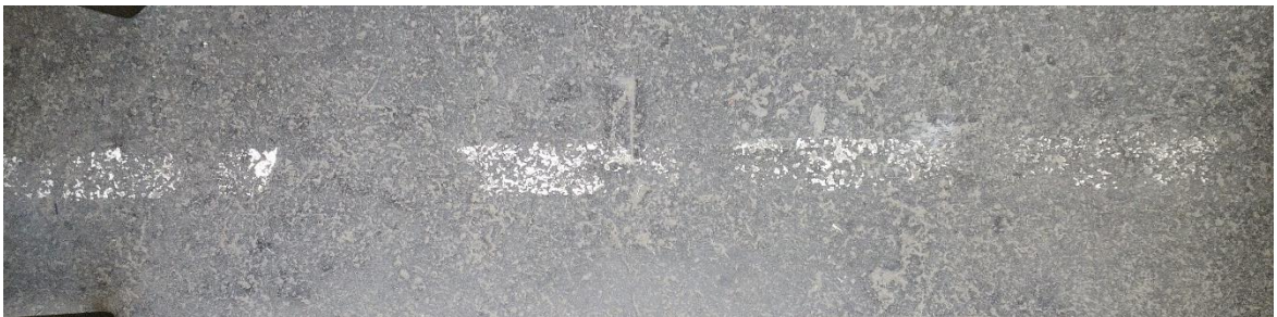
Obr. 35. Ztrácející se vyznačení logistických a manipulačních tras (Interní dokumenty společnosti TON, a. s., 2016; vlastní zpracování)
