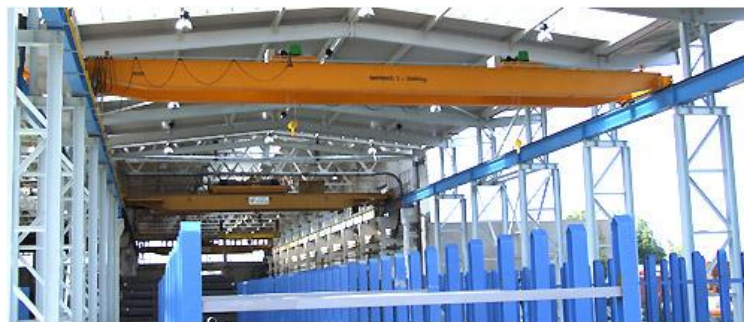
Obr. 20. Mostový žeriav (Interné dokumenty)
