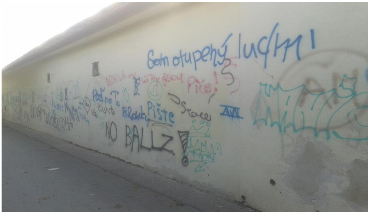
Obrázek 8 Zed' u vstupu do parku poškozená vandaly [Zdroj: autor]
