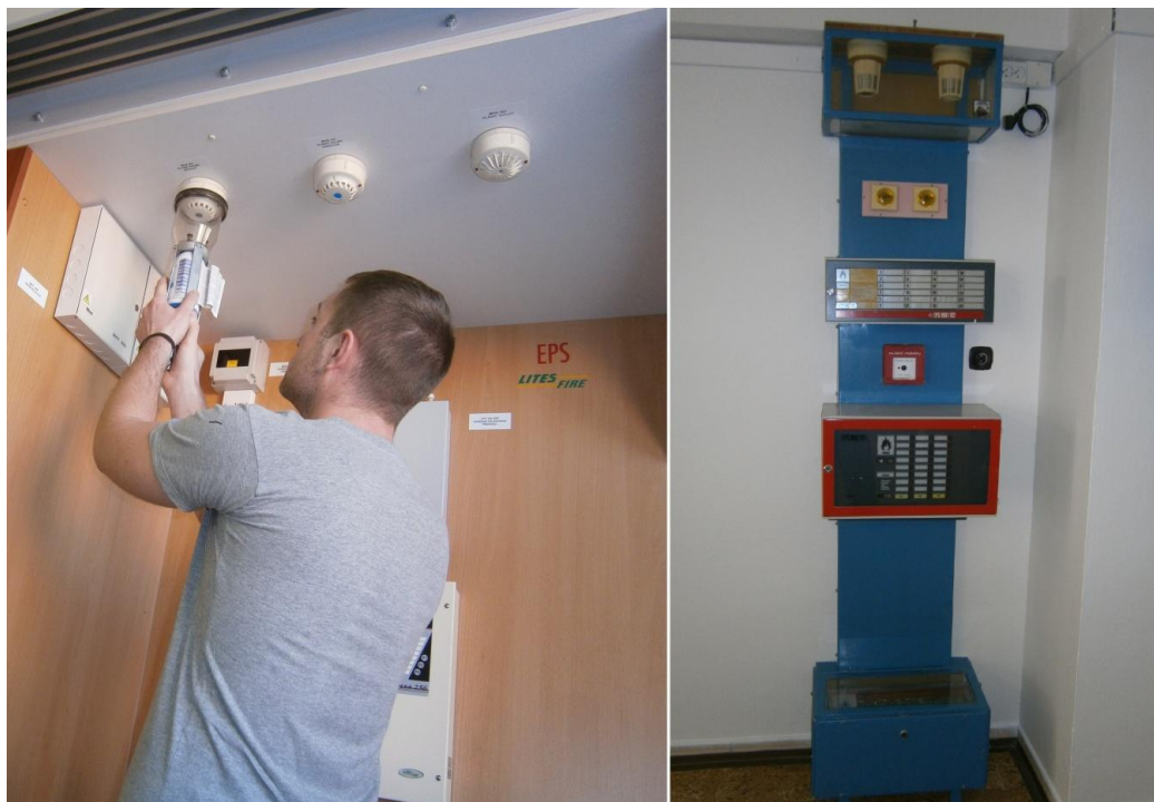
Obr. Zařízení EPS na SOŠ PO a VOŠ PO ve Frýdku - Místku [vlastní]
