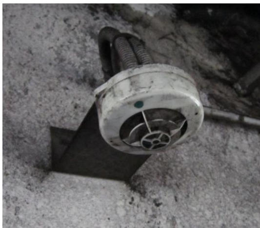
Obr. 14. Zaprášený samočinný hlásič požáru [vlastní]
