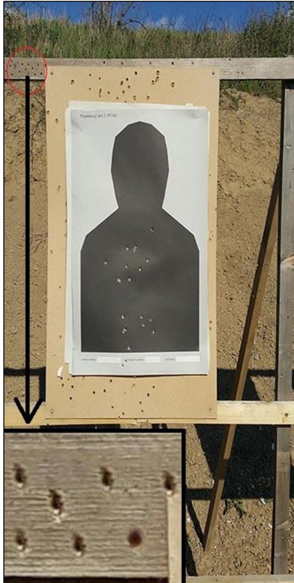
Obrázek 16. Úmyslné poškození konstrukce pro držení terčů
