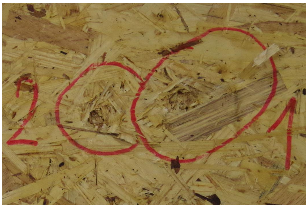
Obr. 56. Detail výstřelných otvorů v OSB desce [Vlastní zdroj]
