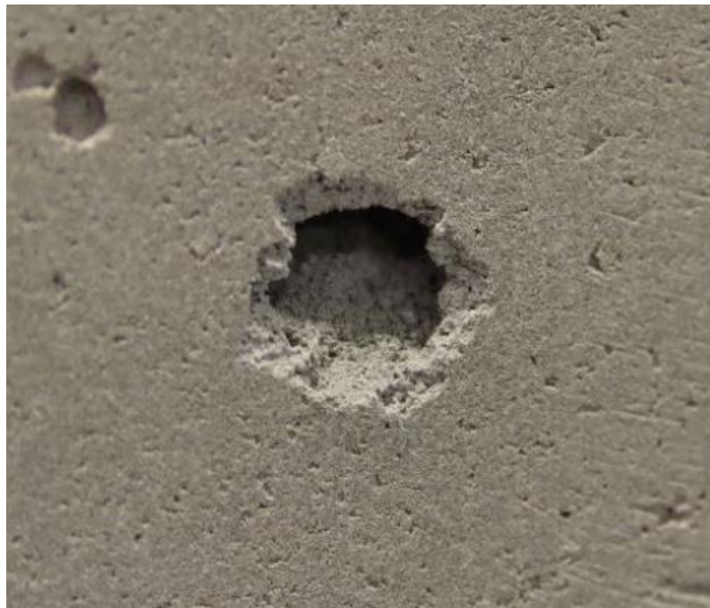
Obr. 17. Vstřelný otvor [Vlastní zdroj]
