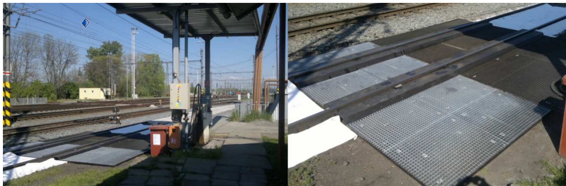
Obrázek 17 Tankovací stanice - druhé výdejní místo - detail záchytné nádrže
