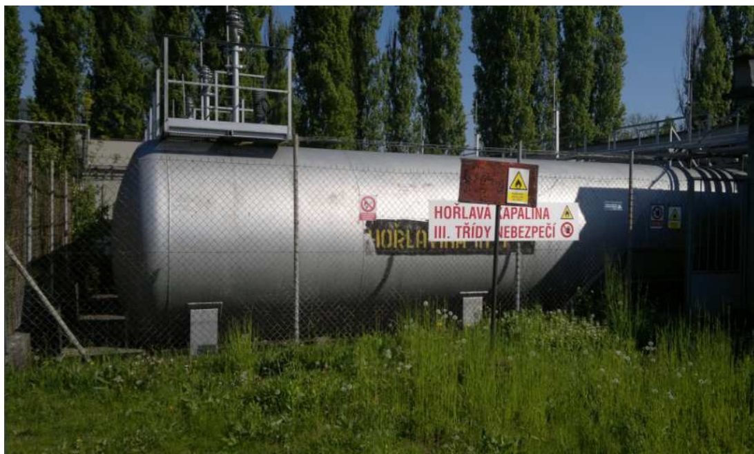
Obrázek 15 Tankovací stanice - nadzemní nádrže
