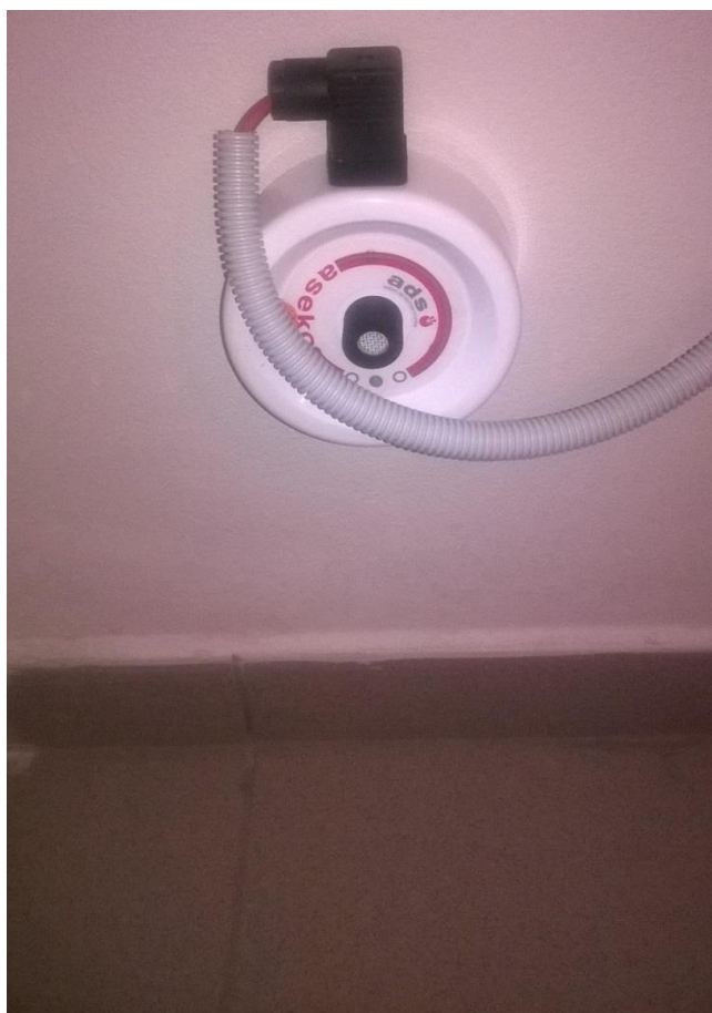
Detekční čidlo na chlór v Aquaparku UH [Zdroj: vlastní]
