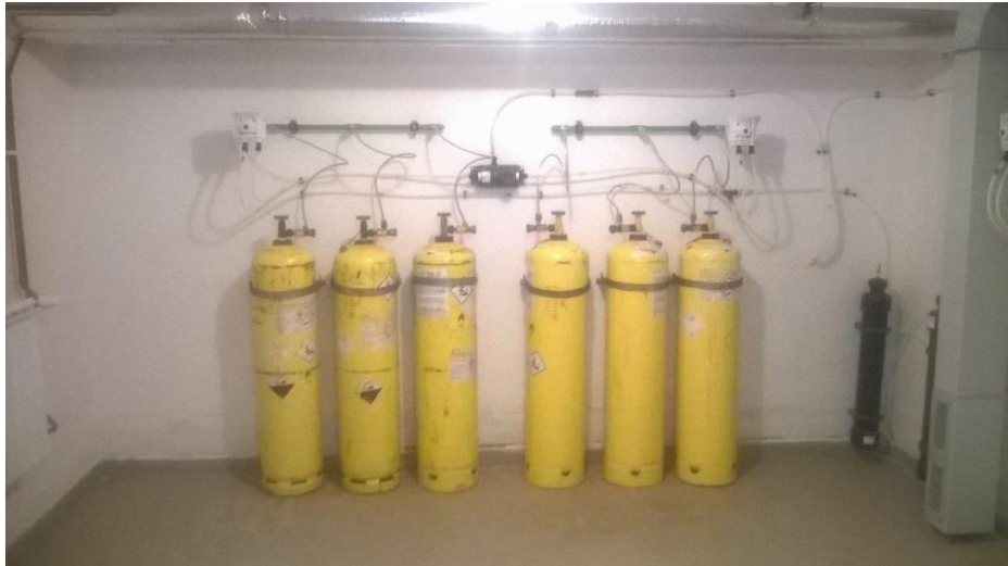
Obr. 7 Tlakové láhve s chlórem v chlorovně Aquaparku Uherské Hradiště [Zdroj: vlastní]
