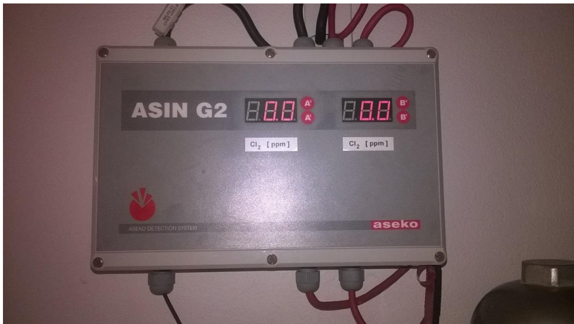
Kontrolní tabule, ukazující případnou koncentraci chlóru v chlorovně v Aquaparku UH [Zdroj: vlastní]
