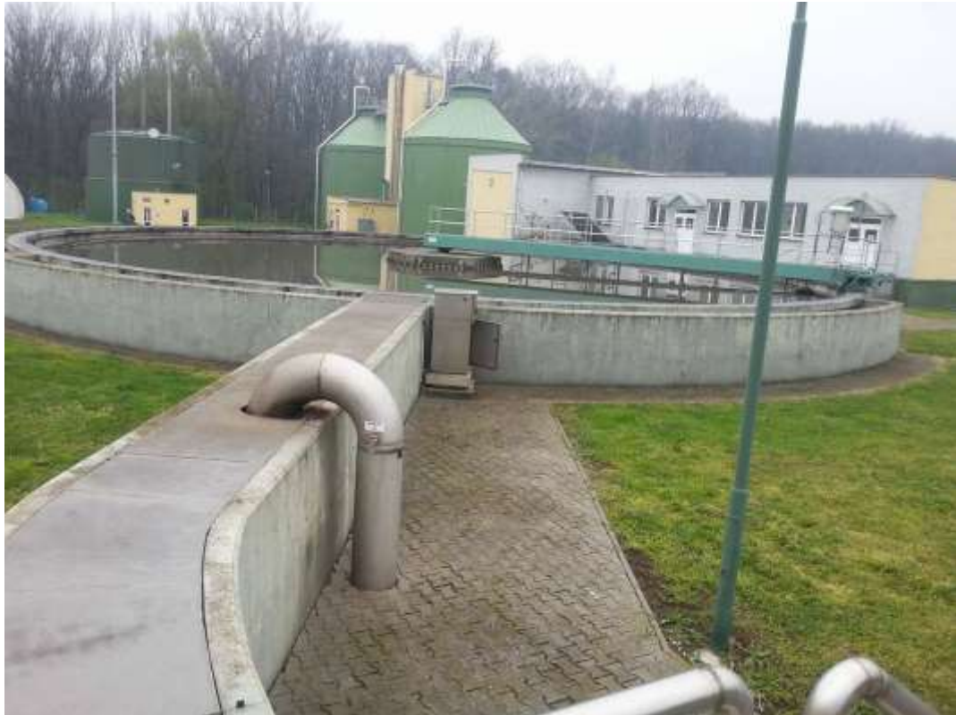
Obr. 1. Usazovací nádrž a fermentační nádrže [foto autor]
