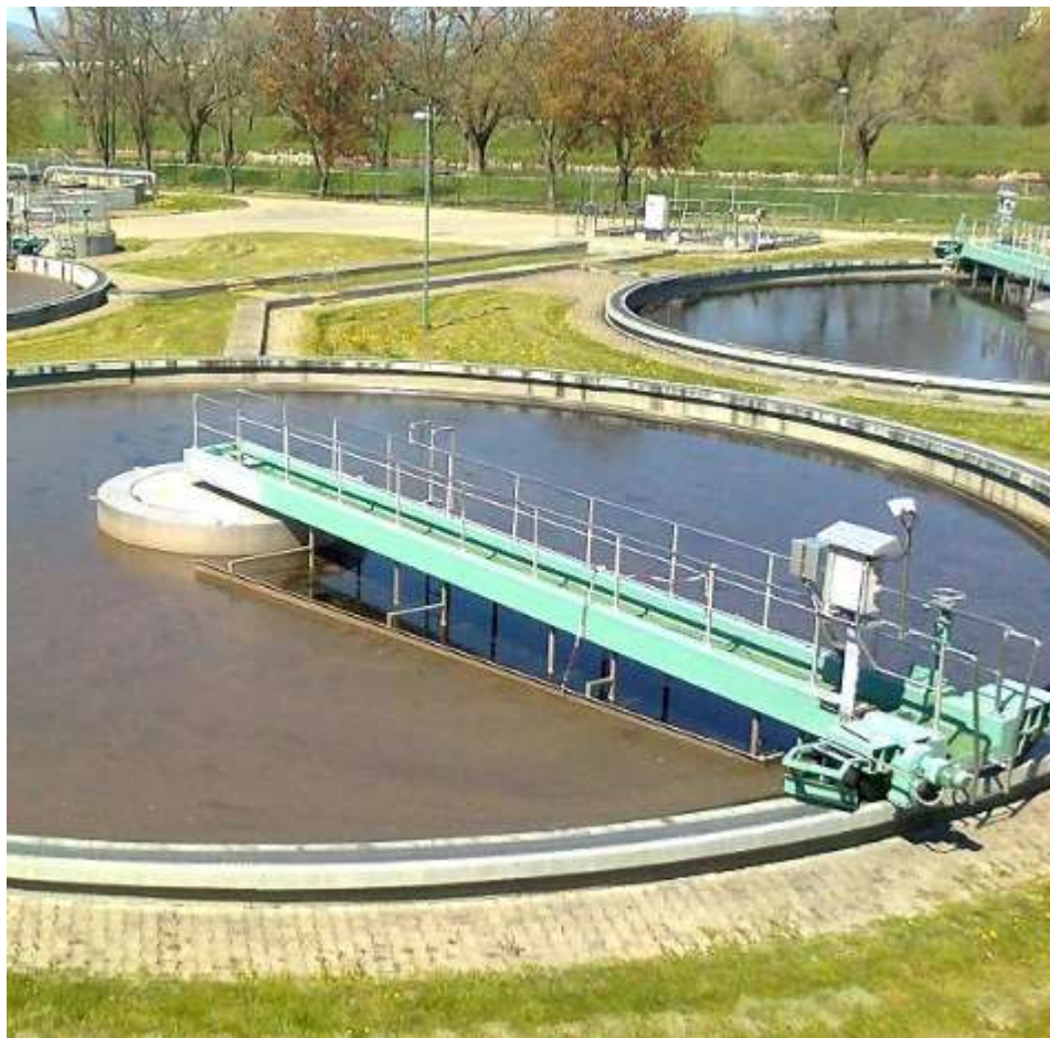
Obr. 4. Dosazovací nádrže [foto autor]
