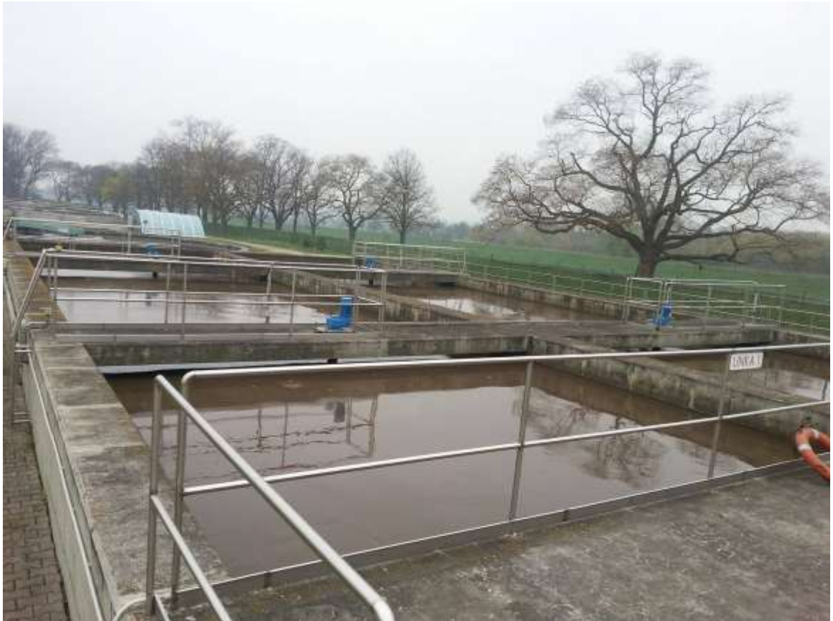
Obr. 2. Anaerobní nádrž [foto autor]
