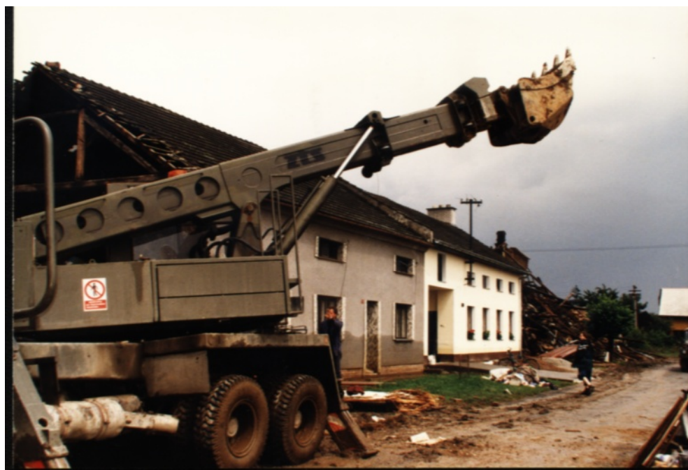
Obrázek č. 20 – Škody po povodni v roce 1997
