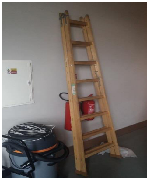
Obr. 4: Znemožněný volný přístup k hasicím přístrojům [Zdroj: vlastní]
