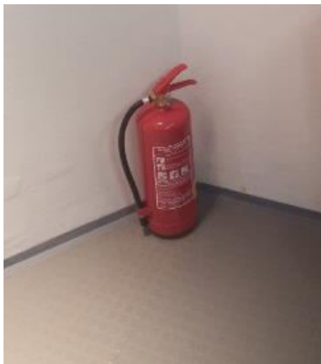
Obr. 5: Hasicí přístroj nezajištěný proti pádu [Zdroj: vlastní]
