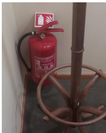
Obr. 6 Nesprávně označené umístění hasicího přístroje [Zdroj: vlastní]
