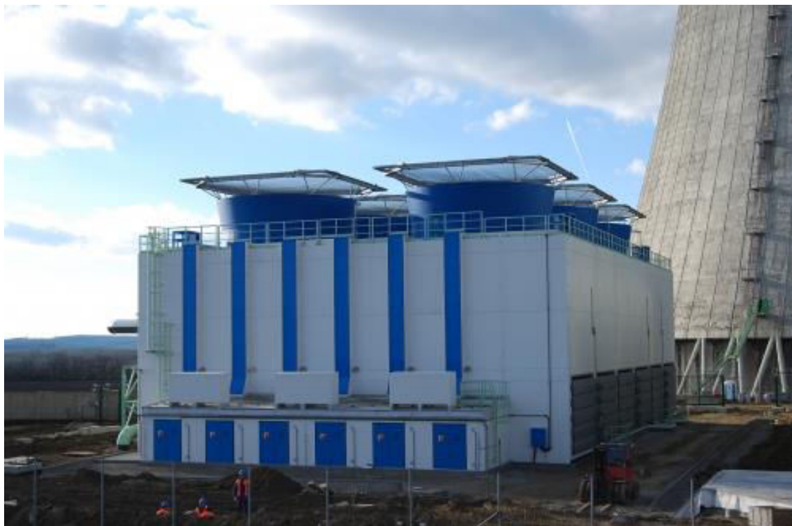
Obrázek 14 Nové chladicí věže (49)
