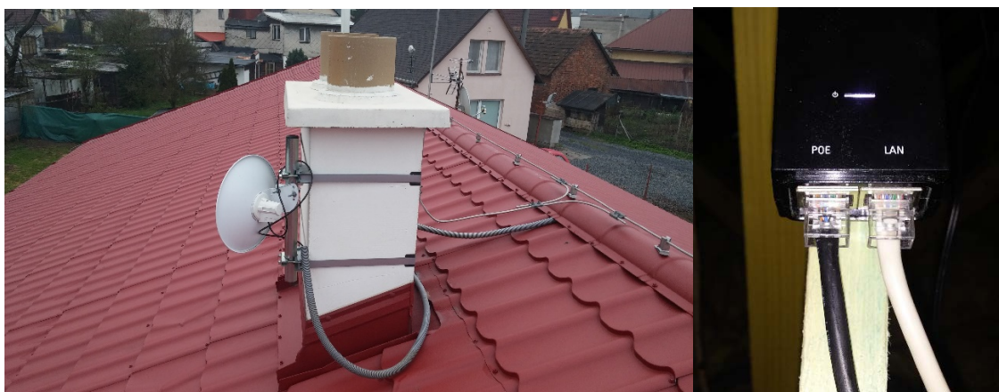
Obr. 25. Instalace radiomodemu UBIQUITI PowerBeam M5 300, zapojení pasivního injektoru.
