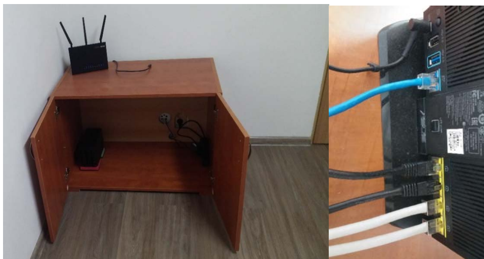
Obr. 26. Router Asus RT-AC68U umístění a zapojení.
