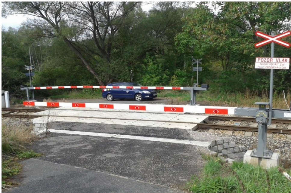
Obr. 3. Železniční přejezd zabezpečen PZM 2
